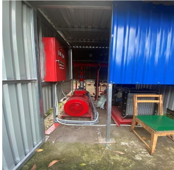
Bơm cấp nước PCCC của nhà máy
