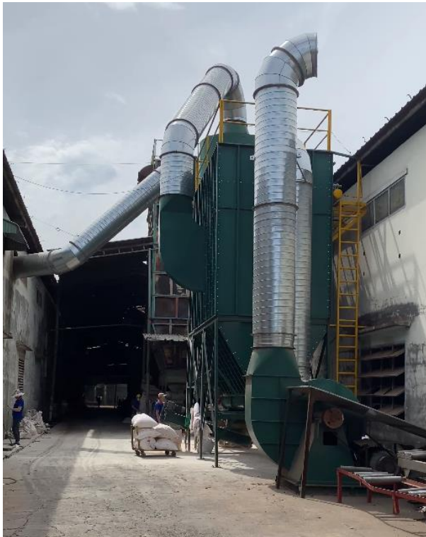
HTXLKT tại công đoạn chà nhám (xưởng sản xuất ván Plywood)
